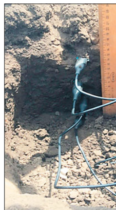
Рис. 4. Датчики влажности почвы, установленные по слоям Fig. 4. Soil moisture sensors installed by layers
